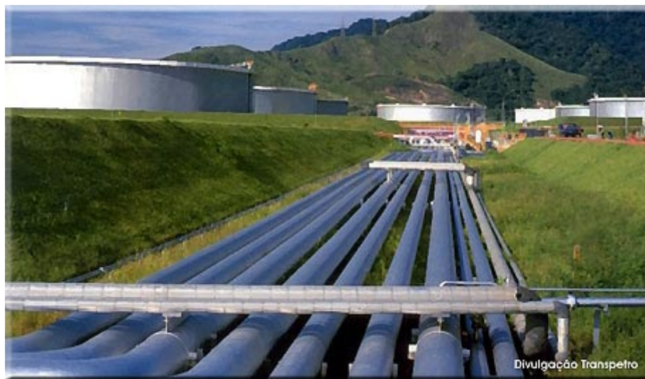
Figura 8: Dutos com sistema SCADA Fonte: Google Images (2008)
